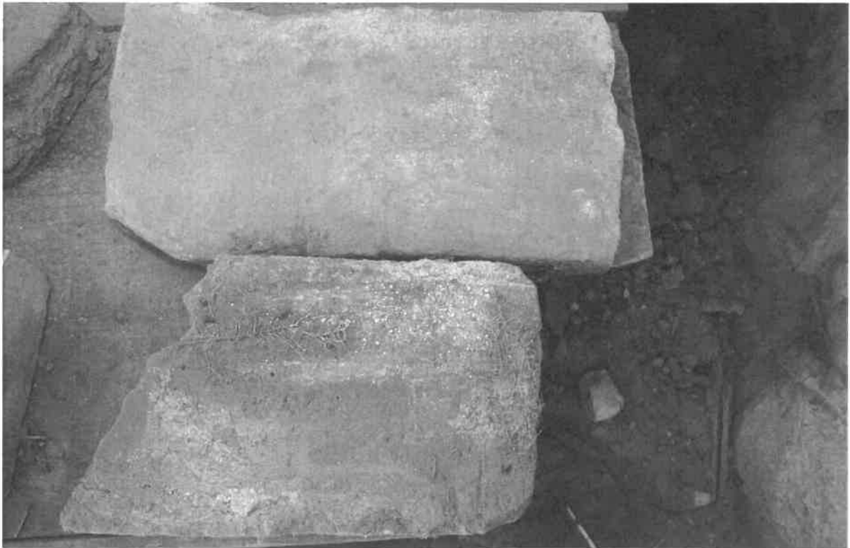
Fot. nr 17 i 18 Kościół w Szczodrowie. Górna fot. – zamurowane okienko w prezbiterium cegłą gotycką o wytartej powierzchni zapewne od chodzenia , fot. dolna – cegły gotyckie wyciągnięte z wykopu w nawie - widoczna grzybnia na powierzchni, cegły cienkie, wytarte na krawędziach. Fot. E. Przebirowska 2020r.
