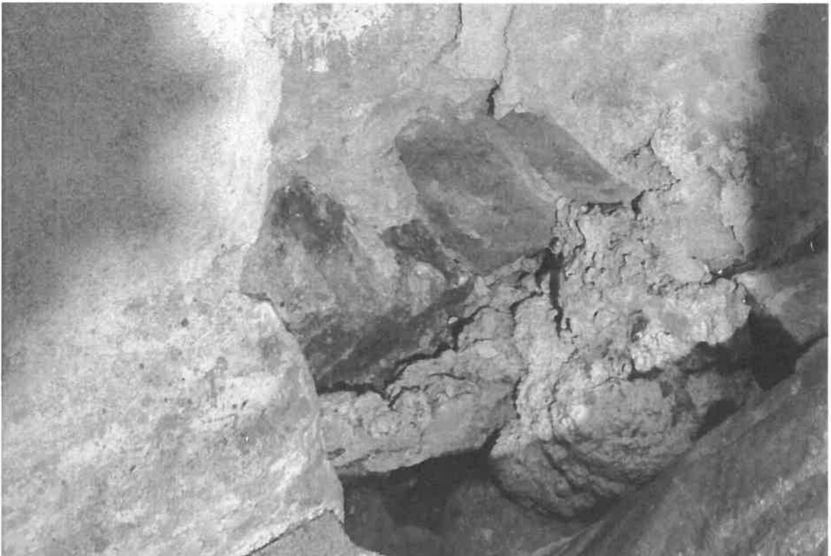
Fot. nr 19 i 20 Kościół w Szczodrowie. Górna fot. –fragment fundamentu w prezbiterium przykryty zaprawą / wystaje ponad posadzkę ok 3 cm. Odkrywka wskazuje, że pod tynkiem jest mur kamienny. Fot. E. Przebirowska 2020r.
